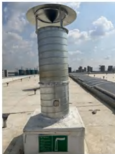
P35 排气筒监测口及环保标识牌
