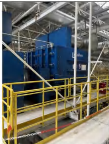
自动焊接区点焊区域配备的5#滤筒除尘设备
