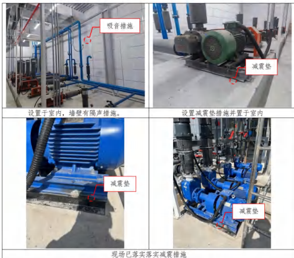
图 4.1-8 该项目噪声治理设施现场照片
