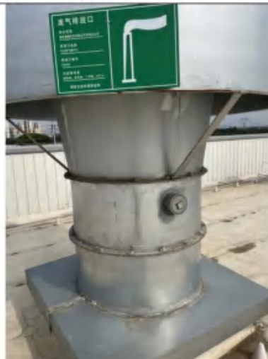
补漆房 P29 排气筒、监测口及环保标志牌。
