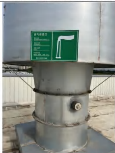
补漆房 P30 排气筒、监测口及环保标志牌。
