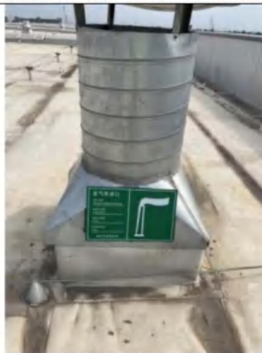
汽油加注工段配备的 P31 排气筒及环保标志牌。
