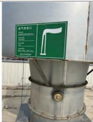
补漆房 P28 排气筒、监测口及环保标志牌。
