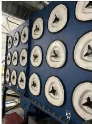
自动焊接区点焊区域配备的8#滤筒除尘设备
