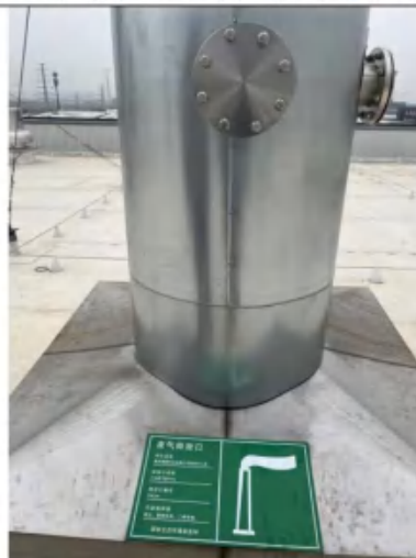
P16 排气筒出口监测口及环保标志牌
