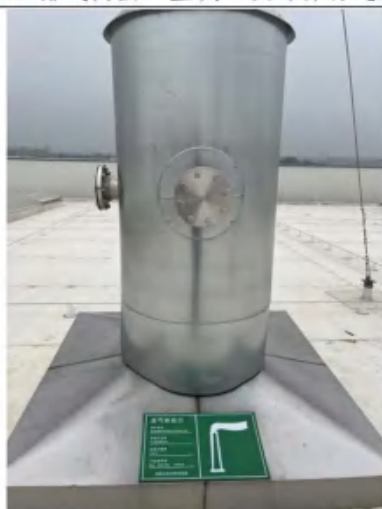
P12 排气筒出口监测口及环保标志牌
