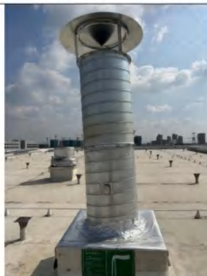
P37 排气筒监测口及环保标识牌
