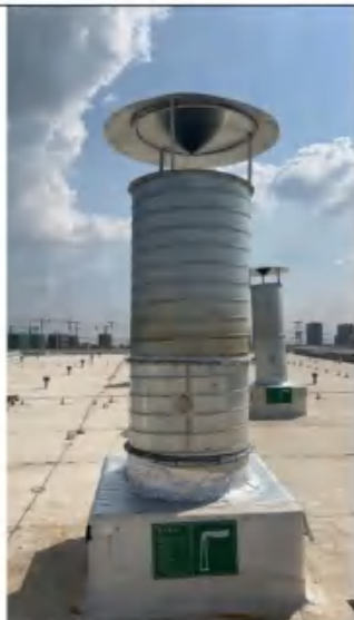
P34 排气筒监测口及环保标识牌
