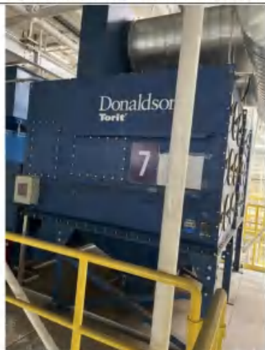
自动焊接区点焊区域配备的7#滤筒除尘设备
