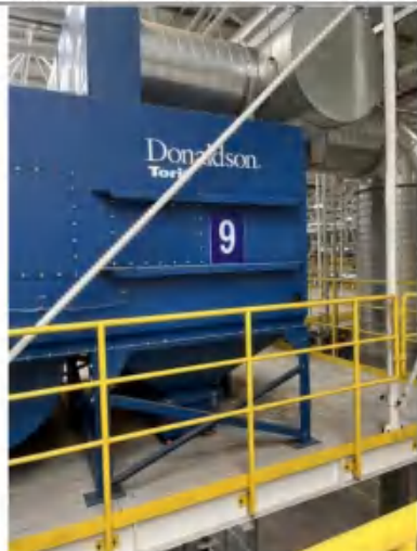
自动焊接区点焊区域配备的9#滤筒除尘设备
