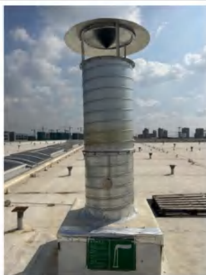
P36 排气筒监测口及环保标识牌
