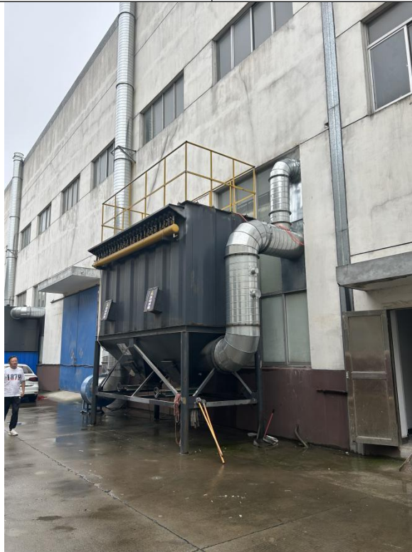
打磨房废气处理设施（袋式除尘器）
