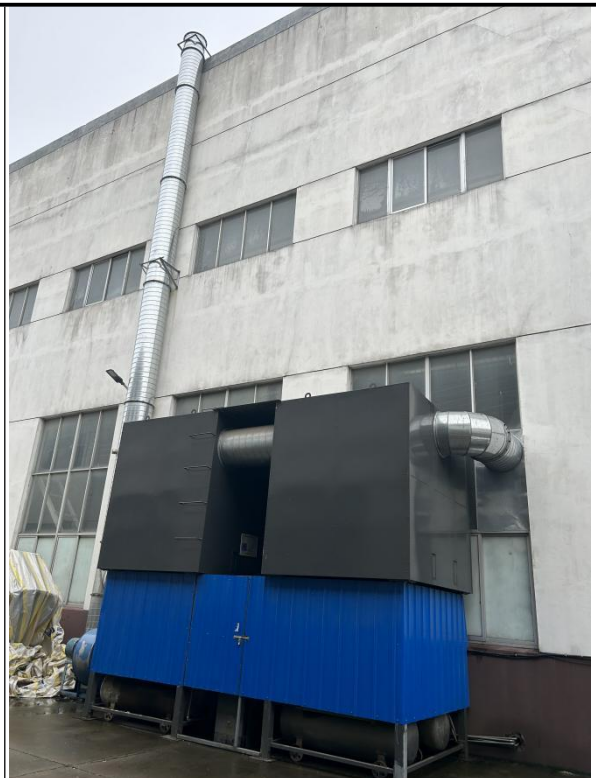
喷漆房废气处理设施（二级活性炭）
