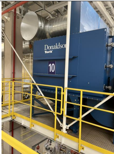
自动焊接区点焊区域配备的10#滤筒除尘设备
