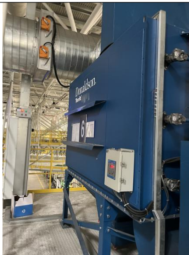
自动焊接区点焊区域配备的6#滤筒除尘设备
