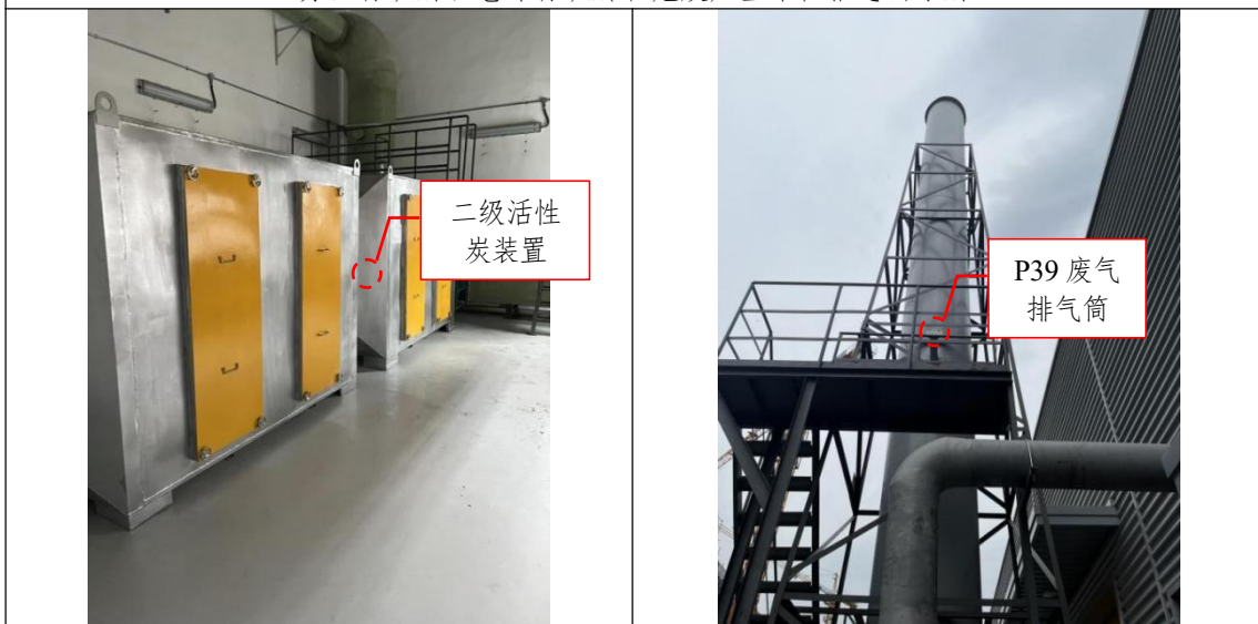
危废仓库配备的二级活性炭吸附装置及 P39 废气排气筒
