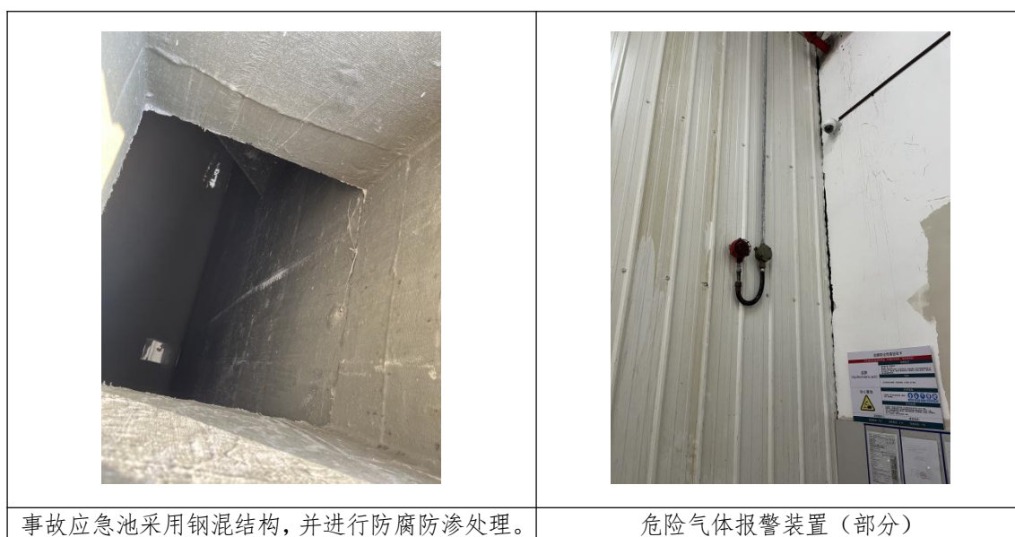
图 4.2-1 该项目事故应急池及气体报警装置建设情况
