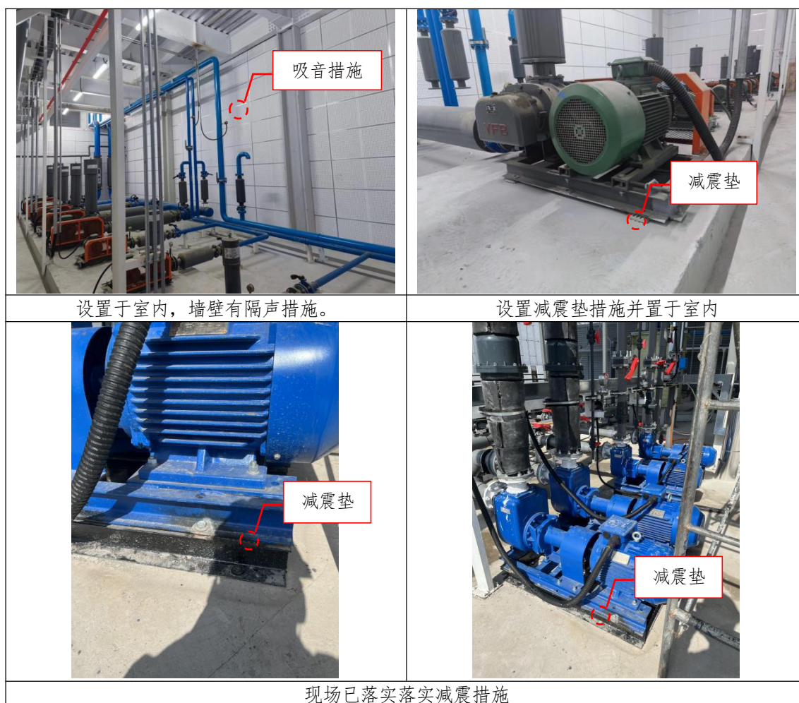
图 4.1-7 该项目噪声治理设施现场照片
