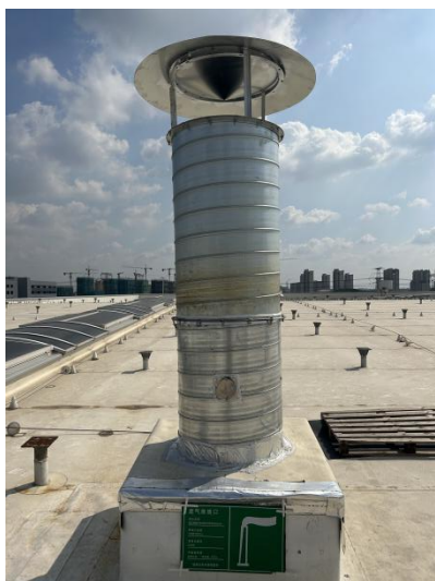
P36 排气筒监测口及环保标识牌
