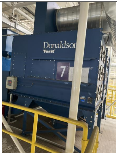
自动焊接区点焊区域配备的7#滤筒除尘设备
