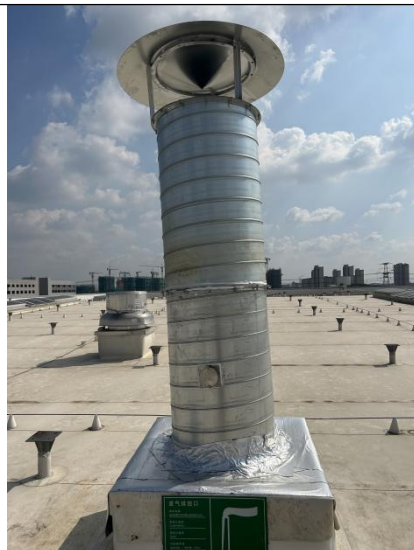
P37 排气筒监测口及环保标识牌
