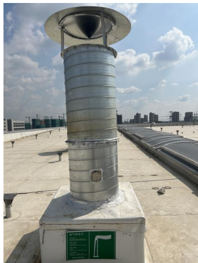
P35 排气筒监测口及环保标识牌
