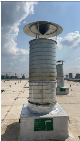
P34 排气筒监测口及环保标识牌
