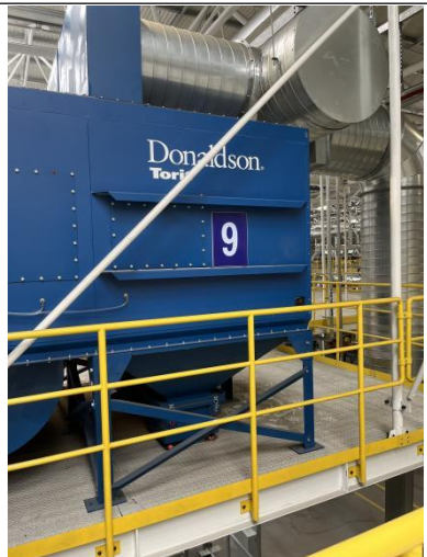
自动焊接区点焊区域配备的9#滤筒除尘设备
