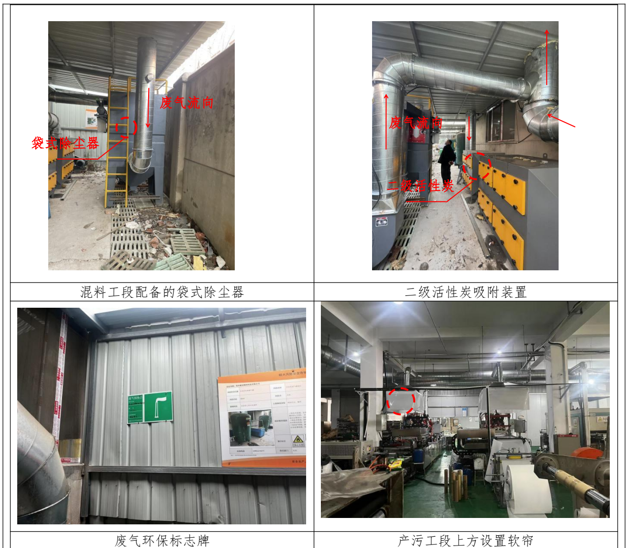
图 3-4 废气处理设施现场情况
