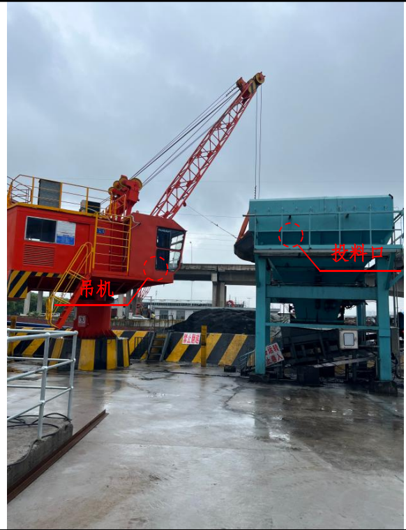
码头配备的吊机（共2台）及相应的投料口
