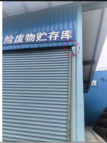
危废仓库外设置监控
