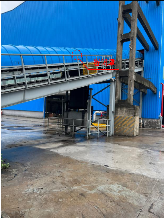
物料输送过程采取密闭罩进行封闭
